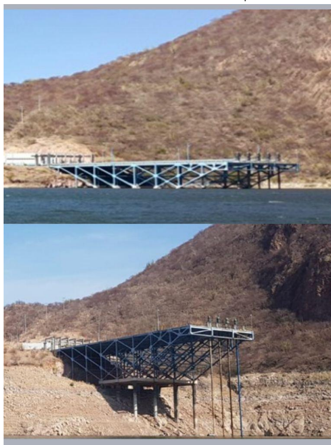
Figura 1. Obra de toma original del Acueducto Independencia, en dos condiciones de elevación de la presa
